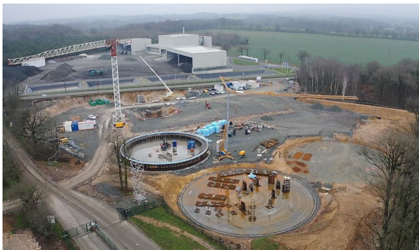
Centrale Biogaz des Coëvrons | SAINTE SUZANNES ET CHAMMES (53)
